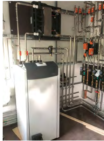
Abb. 02: Wärmepumpe im Energiecontainer [Foto: Ulrich Lüdersen]
