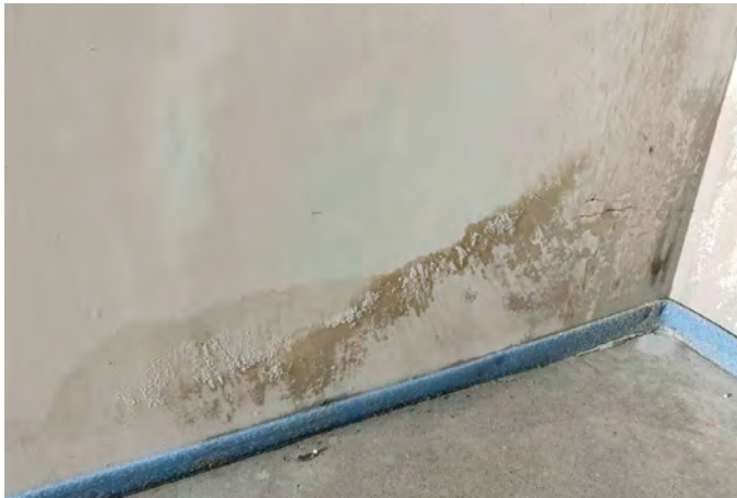
Abb. 07: Kellerwand mit Wasserrändern und Salzausblühungen
