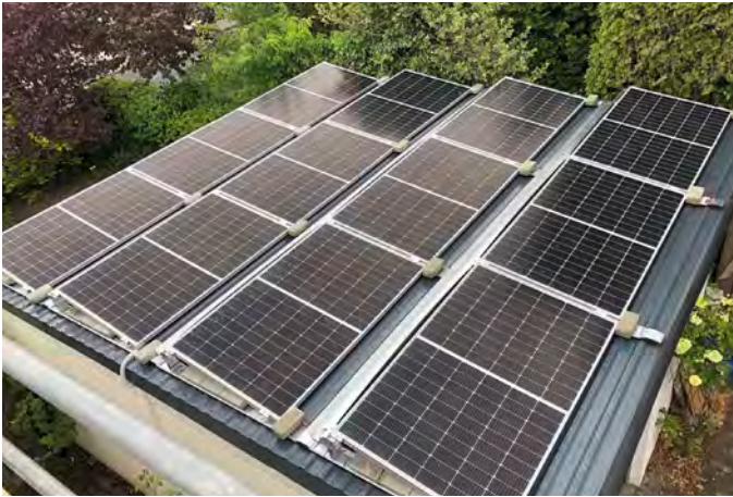
Abb. 03: PV-Anlage auf dem Garagendach
