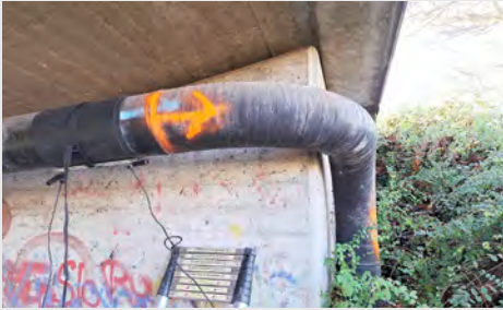
Abb. 03: Isolierte Gasleitung in DN 400 [Foto: Netze BW GmbH]
