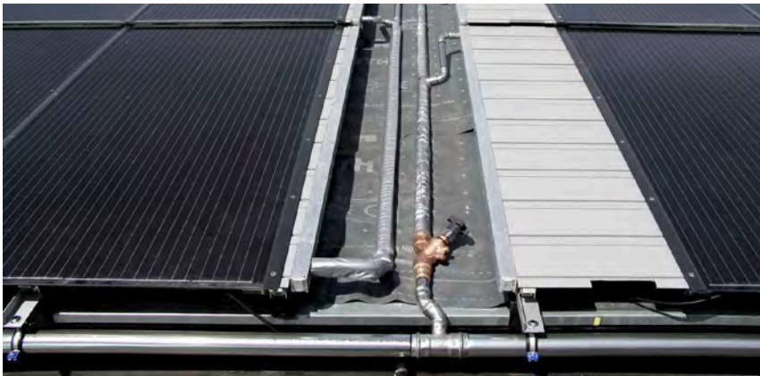
Abb. 03: Hydraulische Anbindung der Wärmeübertragungsfelder (Wartungsgang wird durch PV-Modul verdeckt) [Foto: nD-System GmbH]
