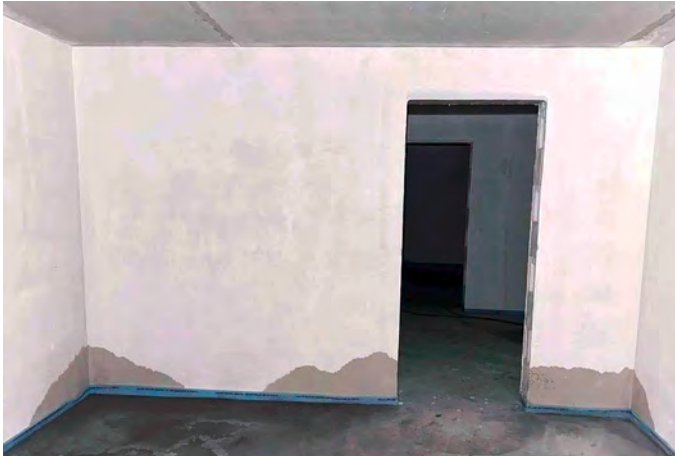
Abb. 02: Durchfeuchtung am Fußpunkt einer Kellerinnenwand
