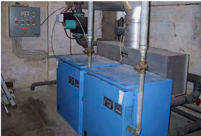
Abb. 02: Bestehende Heizungsanlage mit Konstanttemperaturkessel
