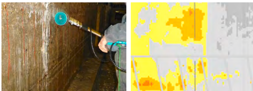
Abb. 07: Potentialfeldmessung an einem Wandsockel, Potentialkarte zur Abgrenzung von Bereichen hoher (rot-orange) und geringer Wahrscheinlichkeit aktiver Korrosion (grau) [Quelle: Dr.-Ing. Sebastian Schulze, bauray GmbH/hupfer ingenieure]
