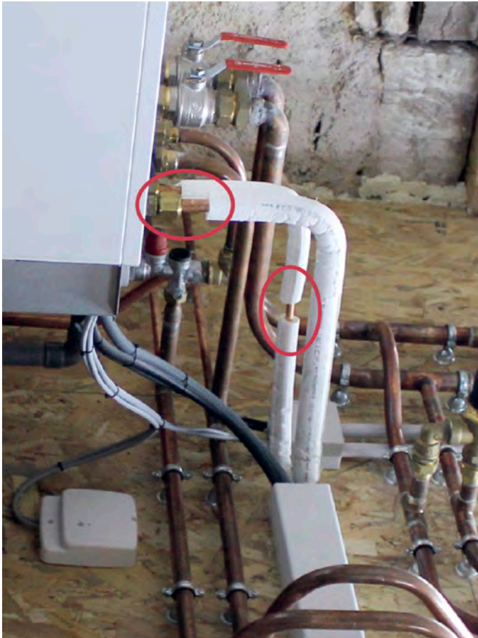
Illustration 2: Isolation incomplète du réseau frigorifique [©AQC]
