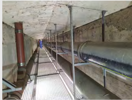
Abb. 04: Wasserleitung DN 200 und Gasleitung DN 300 werden auf Beschädigungen bzw. den Zustand der Rohraflager geprüft. [Foto: Netze BW GmbH]
