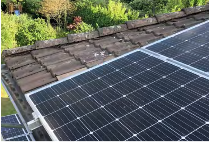
Abb. 01: Teil der PV-Anlage auf dem Hauptdach
