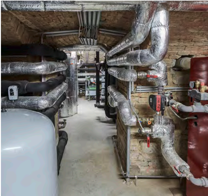
Abb. 02: Haustechnikzentrale im Bestandskeller [Foto: Kurt Hoerbst]
