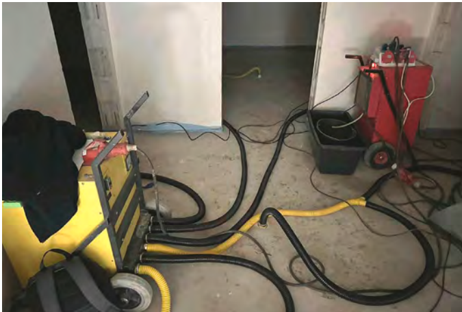
Abb. 05: Trocknungsanlage in einem Kellerraum
