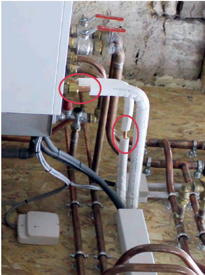
Abb. 02: Unvollständige Dämmung des Leitungssystems [Foto: AQC]
