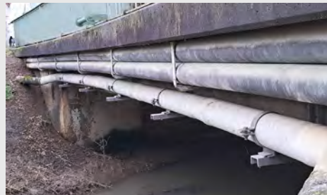
Abb. 06: Zementumhüllte Gasleitung DN 150 auf Zustand der Leitung, Rohraufleger und Gasaustritt geprüft [Foto: Netze BW GmbH]
