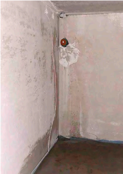
Abb. 01: Kelleraußenwand mit Wasserablaufspuren unterhalb einer Wanddurchdringung
