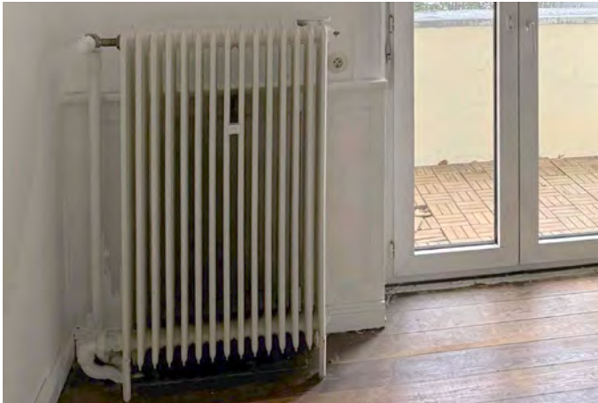
Abb. 03: Bestehender Heizkörper (Gussradiator)
