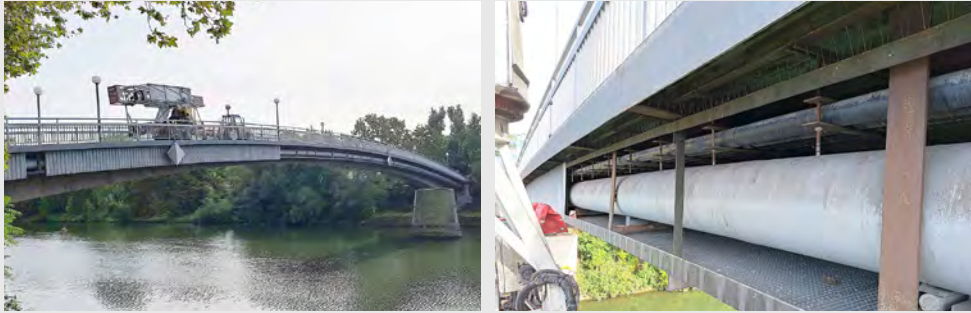
Abb. 02: Mithilfe eines Brückenuntersichtgeräts wurden die Gasleitungen (2x DN 400) auf ihren Zustand geprüft. Hierfür wurde die Blechverkleidung an mehreren Stellen demontiert. Im Zuge dieser Prüfung konnten die Auflager und Rohrteile einer Sichtprüfung unterzogen werden. [Foto: Netze BW GmbH]
