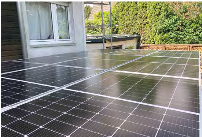
Abb. 02: PV-Anlage auf einem Nebendach
