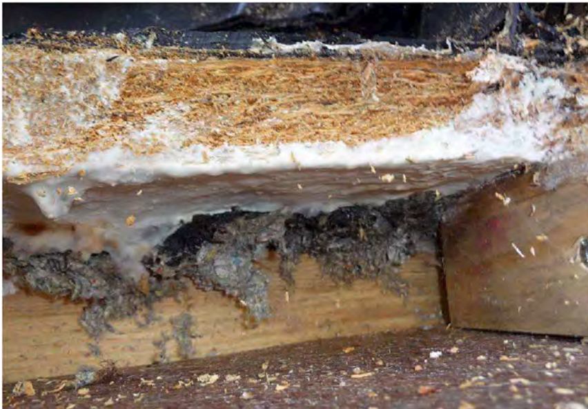
Abb. 14: Fatale Schädigungen infolge von konvektivem Feuchteintrag über Undichtheiten in eine Holzkonstruktion [Foto: Studie zum Lüften im Wohnungsbau]
