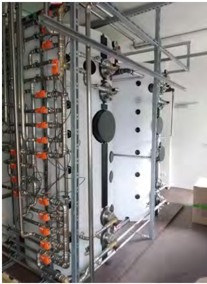
Abb. 01: Nieder- und Hochtemperaturspeicher [Foto: Ulrich Lüdersen]
