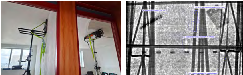
Abb. 05: Untersuchungsaufbau und Röntgenbild einer hochbelasteten Elementwand für das Anlegen von Kernbohrungen ohne Bewehrungstreffer und Fehlbohrungen: Erkennbar sind Bewehrungsstäbe, A-Böcke der Fertigteilschalen sowie Abstandhalter (Kunststoffräder). [Quelle: Dr.-Ing. Sebastian Schulze, bauray GmbH/hupfer ingenieure]
