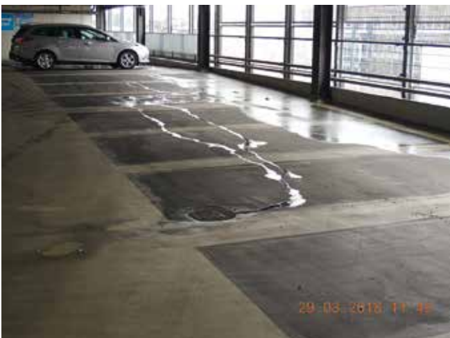
Abb. 33: Keine Pfützenbildungen aufgrund eingeschleppten Wassers/Schnees auf dem Zwischendeck eines Einkaufsmarkts (geplantes Gefälle der Stahlbetondecke: 2 %)
