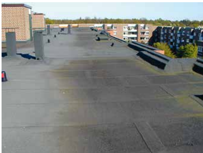
Abb. 8: Nicht genutztes Dach ohne geplantes Gefälle mit Pfützenbildung/ Schmutzablagerungen im Bereich von Deckendurchbiegungen (© H.-H. Wetzel)
