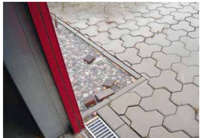
Abb. 42: Nicht nur im Kiesstreifen, sondern auch in der unmittelbar vor der barrierefrei ausgebildeten Türschwelle angeordneten Entwässerungsrinne staut sich das Wasser bis zur Oberkante Gelände (© M. Lunow)
