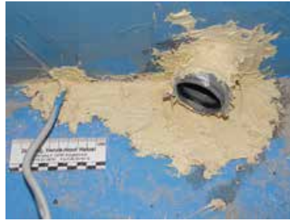
Abb. 61: Misslungener Abdichtungsversuch der im Eckbereich angeordneten Durchdringungen in Verbindung mit der unter der Duschwanne angeordneten AIV
