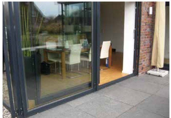
Abb. 41: Typisches Beispiel eines nicht unterkellerten Wohnhauses, bei dem das Niveau der Terrasse auf das Niveau des Fußbodens angehoben wurde
