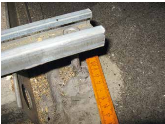
Abb. 13: Mangelhafte Abdichtung einer zur Windsogsicherung einer Solaranlage verwendeten Gewindestange mit Flüssigkunststoff (© T. Platts)
