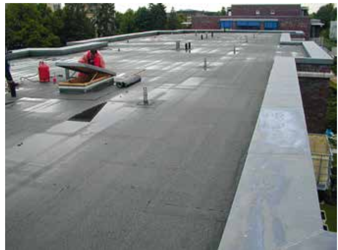
Abb. 10: Nicht genutztes Dach mit ausreichend geplantem Gefälle und normaler Pfützenbildung (© H.-H. Wetzel)
