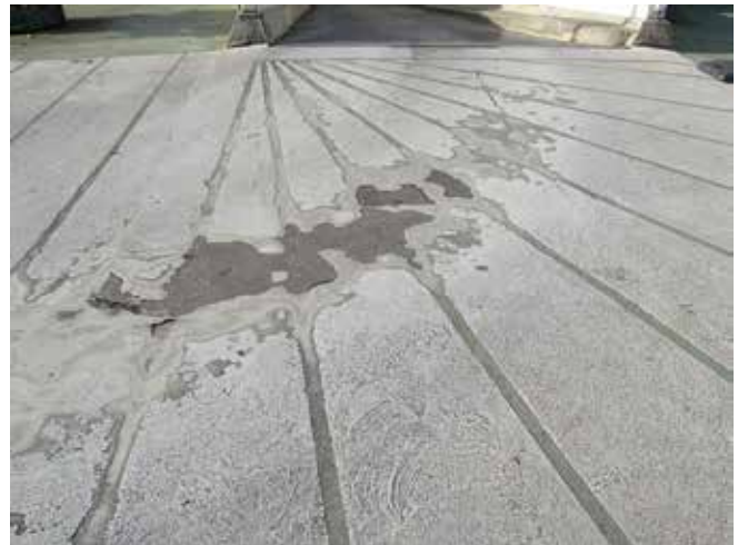
Abb. 36: Rissüberbrückendes Beschichtungssystem im oberen Bereich der Zufahrtsrampe eines Parkdachs, welches zugleich die Abdichtung des Parkdachs übernehmen sollte
