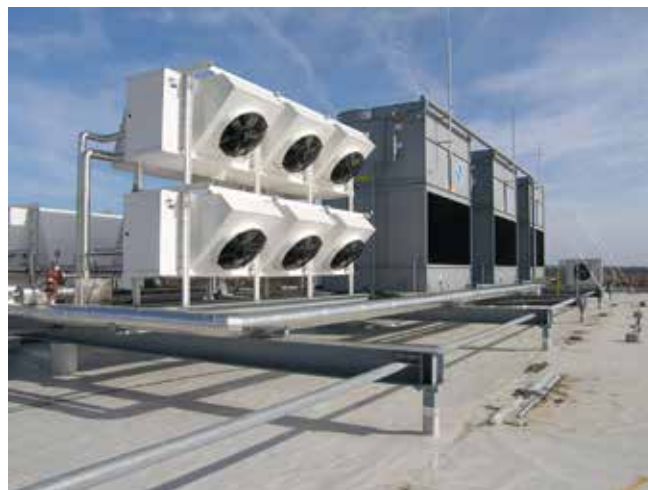
Abb. 14: Aufbau technischer Anlagen mit aus abdichtungstechnischer Sicht gutem Abstand zwischen Unterkante Technik und Oberkante Dachoberfläche (© H.-H. Wetzel)
