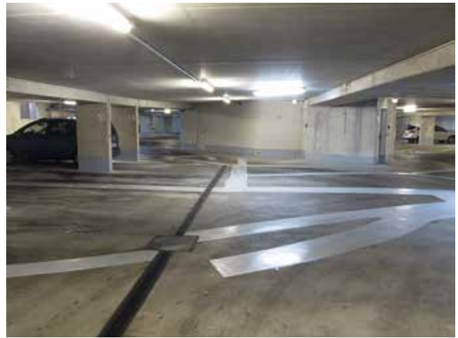
Abb. 35: Keine Fahrbahnmarkierungen, sondern das Ergebnis eines kürzlich gewarteten Oberflächenschutzsystems
