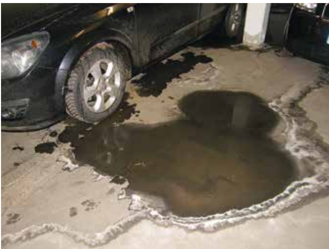
Abb. 32: Wiederholte Pfützenbildungen aufgrund eingeschleppten Wassers/Schnees in der Garage einer Wohnanlage (geplantes Gefälle der Gussasphaltschicht: 0 %)
