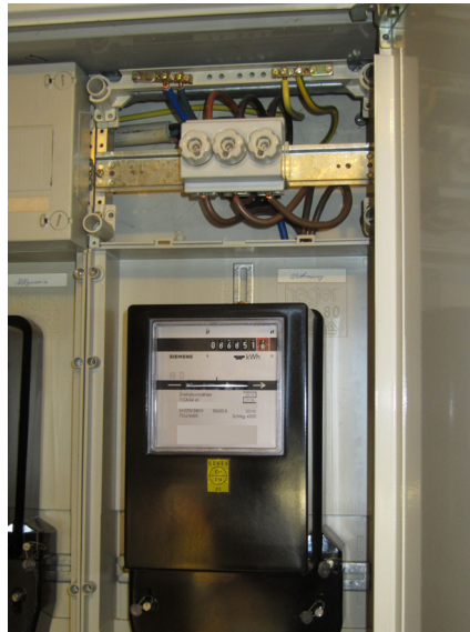
Abb. 4: Wird nach und nach zurückgebaut: der gute alte »Ferraris-Zähler«
